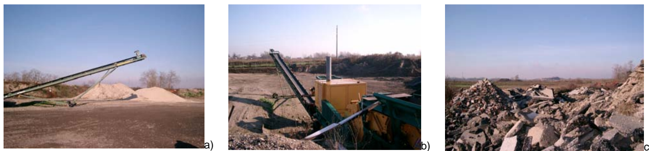
Slika 11.: Mobilno postrojenje za uporabu građevinskog otpada na lokaciji Ivanovec-Preloge
